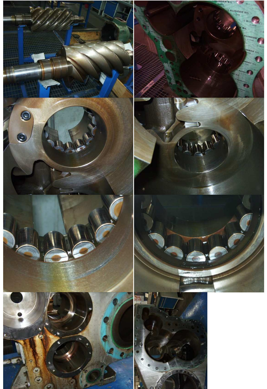
REVISIONE COMPRESSORE SABROE S 85
